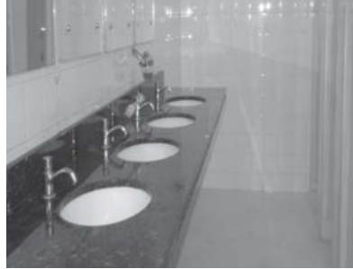
Foto 4: Banheiros sem acessibilidade
